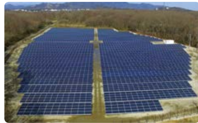
東武岩舟太陽光発電所
