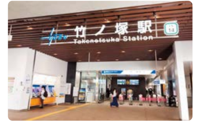
竹ノ塚駅改札口天井照明
