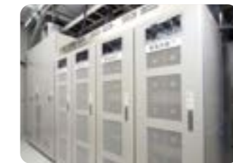
回生電力貯蔵装置
