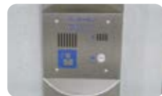
非常用インターホン
