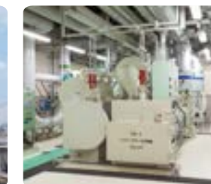
錦糸町熱供給施設
